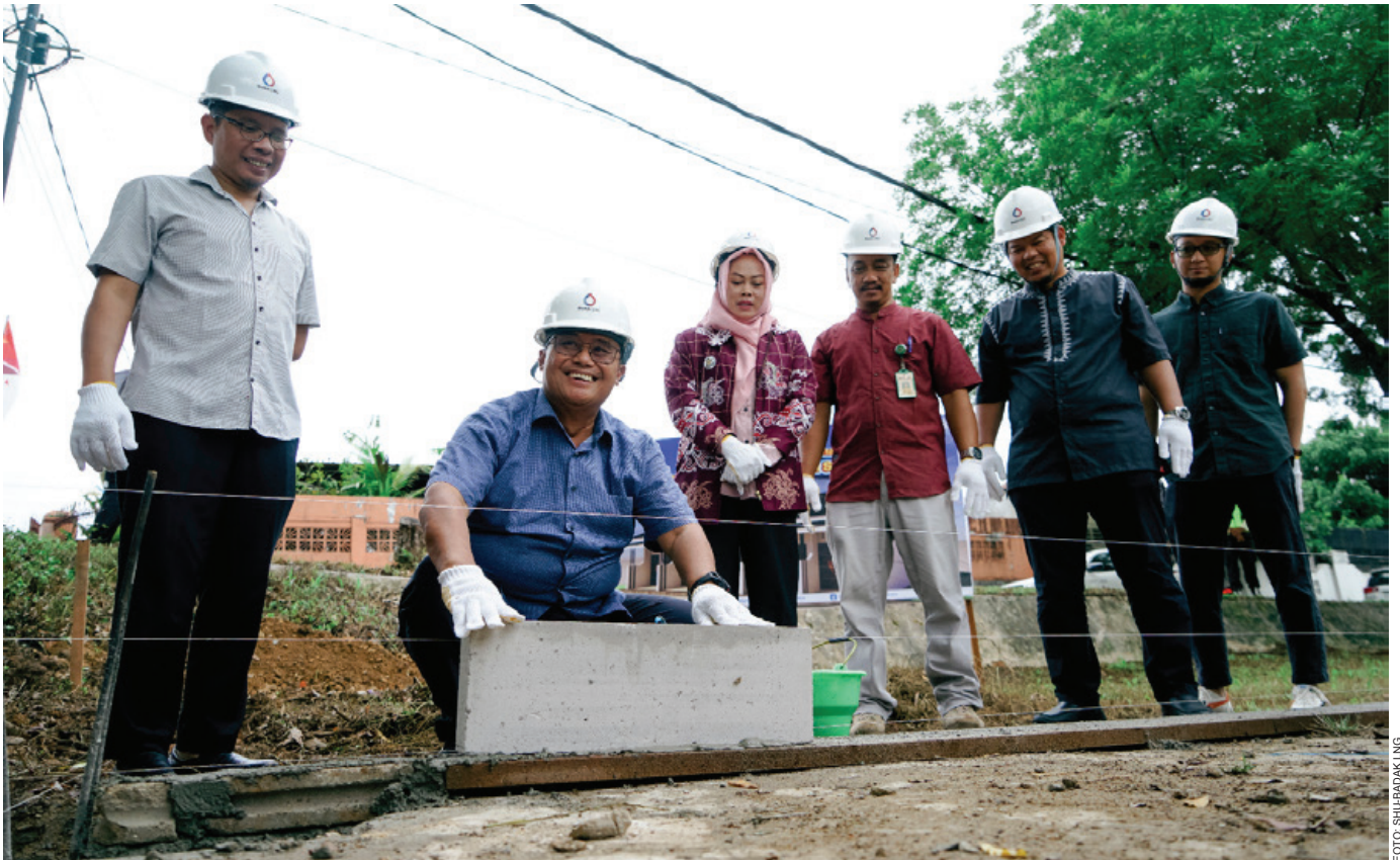
FOTO: SHU-BADAK LNG
